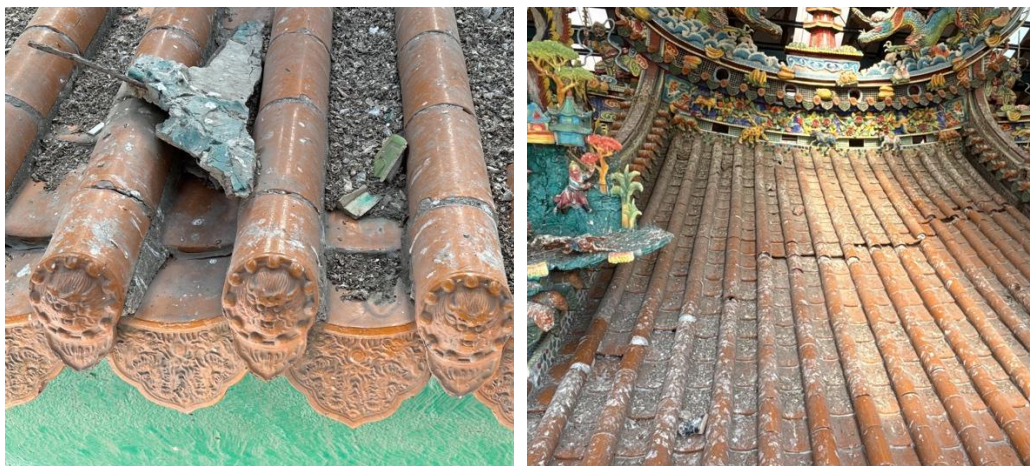
圖三十三、圖三十四 章寶宮正殿屋頂破損情況
